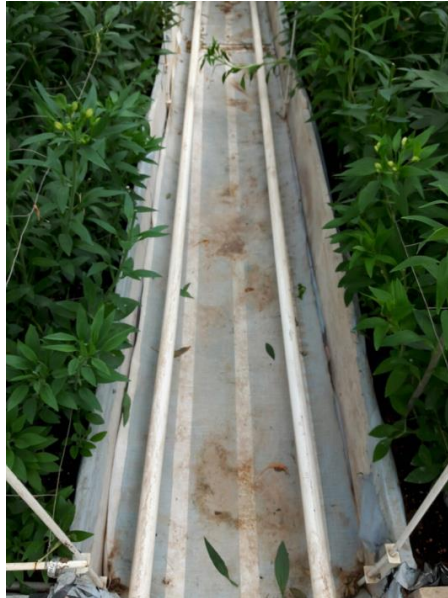
شکل ۴۶: نمایی از سیستم شوفاژ گلخانه پاکدشت ورامین
