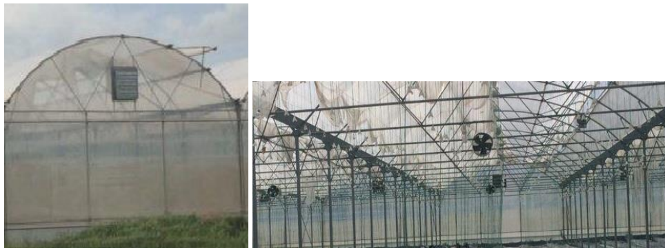
شکل (۱۱): فن تهویه هوا و فن توزیع حرارت گلخانه مهاباد
