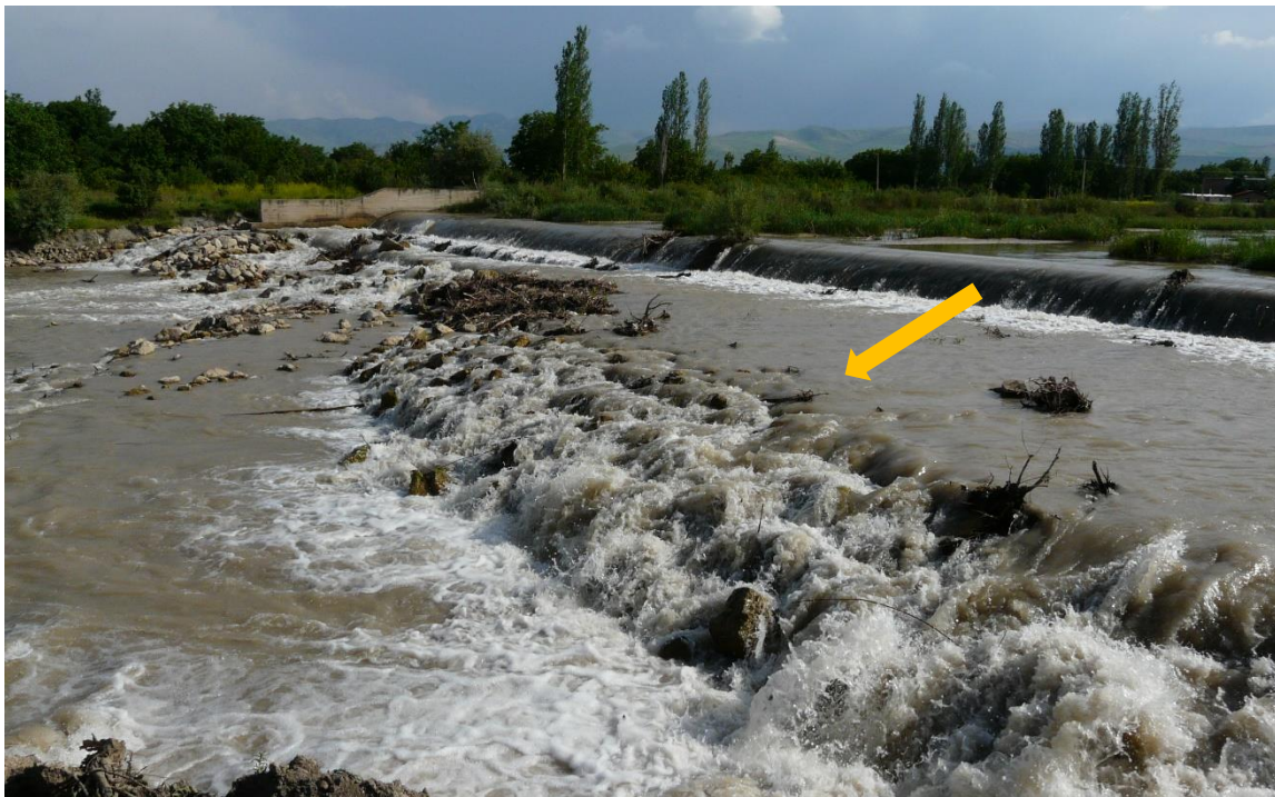
شکل ۲۰- نمای کلی بند حاجی و تخریب ریپرپ پایین دست آن در رودخانه باراندوزچای در زیربازه BC از بازه محل اتصال رودخانه درین قلعه به باراندوزچای - ایستگاه هیدرومتری دیزج
