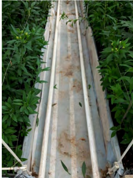
شکل(۴۶): نمایی از سیستم شوفاژ گلخانه پاکدشت ورامین
