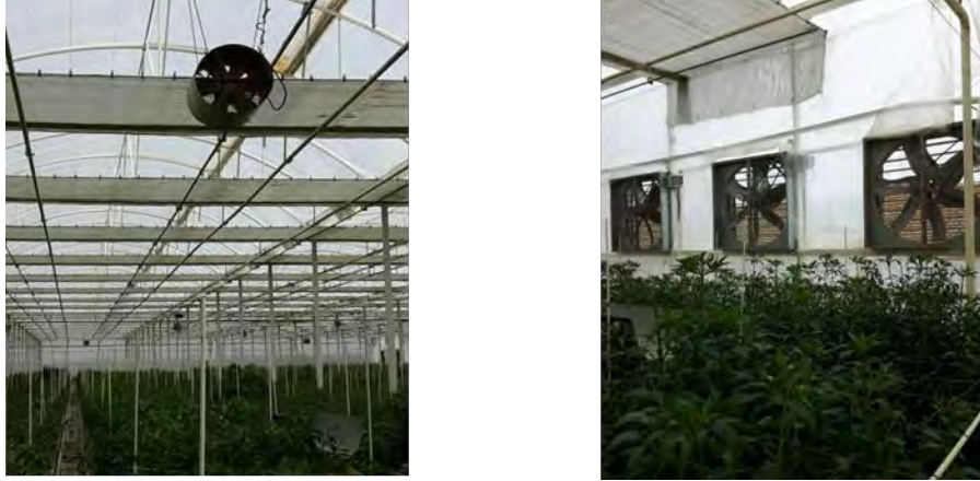
شکل(۴۸): فن تهویه هوا و فن توزیع حرارت گلخانه پاکدشت ورامین
