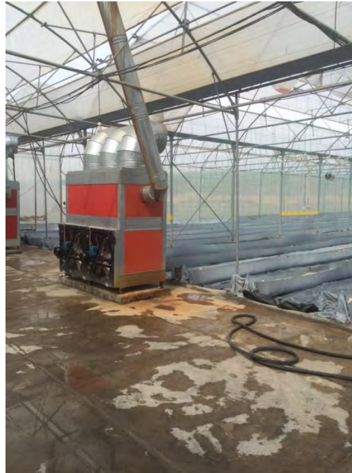
شکل (۱۰): بخاری هوای گرم مورد استفاده در گلخانه مهاباد
