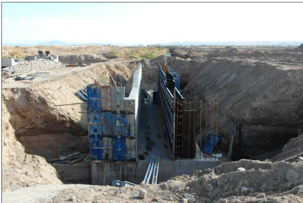
شکل ۳-۴- عملیات سردهنه‌سازی و نصب دریچه در نهر مسگرزاده در دشت تبریز بتاريخ ۹۷/۸/۲۲
